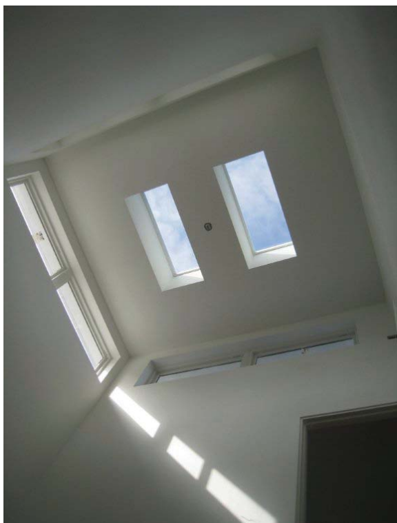
Thermal chimney’s ventilating skylights
